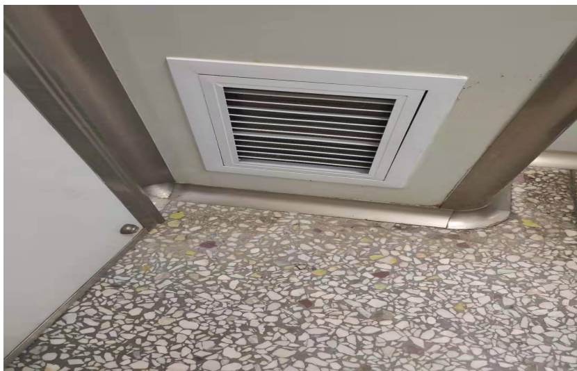
机械换气排口
