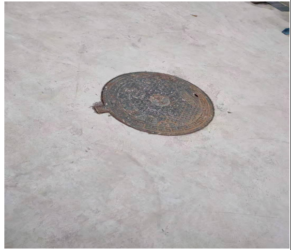
生活区化粪池
