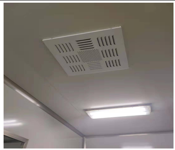
车间内高效过滤器
